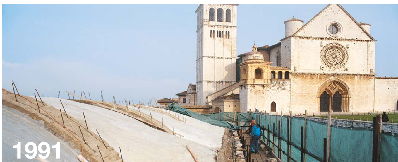
1991 Sala Norsa, Assisi (PG). L'edificio consolidato con materiali Kimia nel '91, resistette al terremoto del 1997, fungendo da base d'appoggio per i soccorsi.
